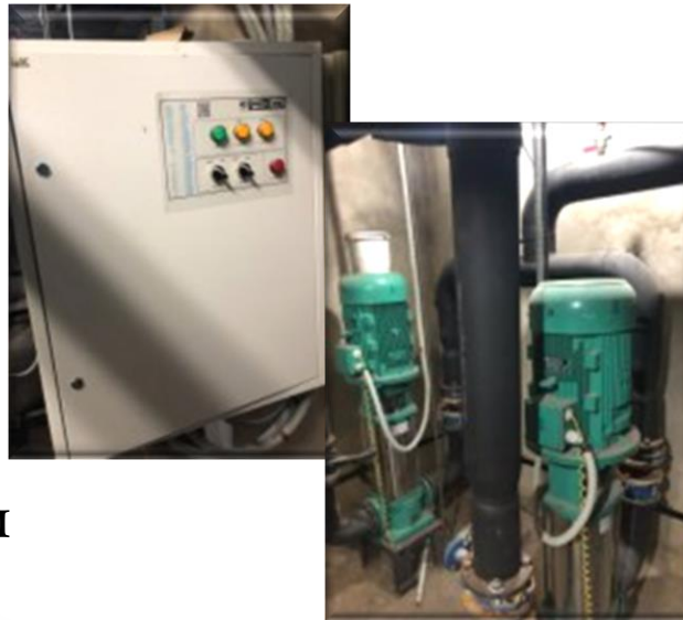
Шкаф управления противопожарными насосами
